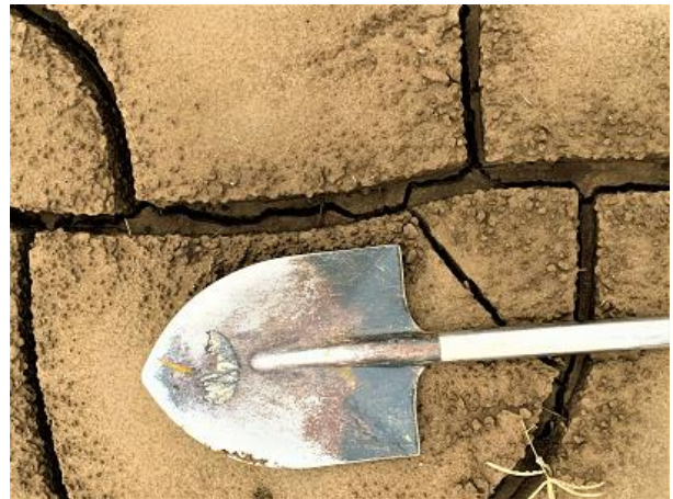
図 2 堆積土に発生した幅 2～5 cm のクラック
